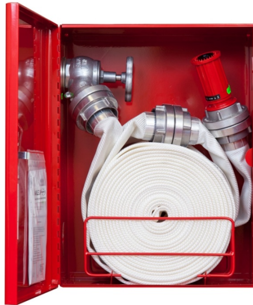
Zdjęcie nr 19. Widok przykładowego wyposażenie hydrantu wewnętrznego 25.
