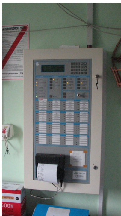
Zdjęcie 17. Widok Centrali sygnalizacji pożarowej.
