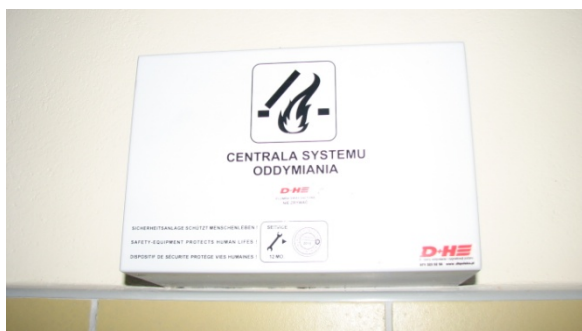
Zdjęcie nr 15 oraz nr 16. Widok centrali systemu oddymiania.
