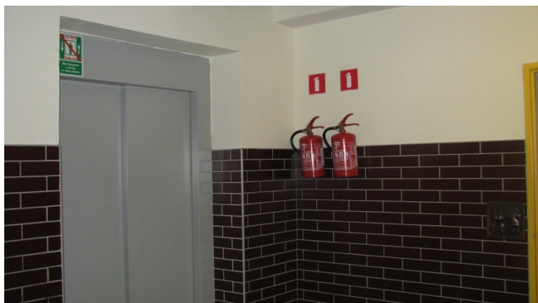
Zdjęcie nr 24. Widok gaśnic.
